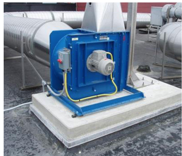
Вентилятор размещен на крыше.
